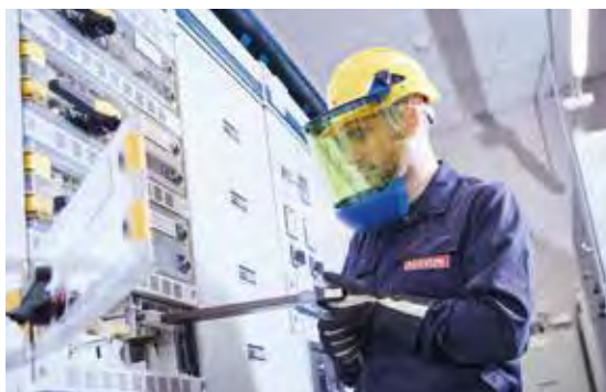
Unsere Fachleute sorgen für zuverlässige Elektrotechnik im Hintergrund
